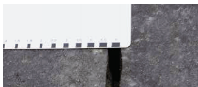
Die Mindestfugenbreite muss durchgängig vorhanden sein. Achten Sie hierauf bei Belägen mit Abstandhaltern.
