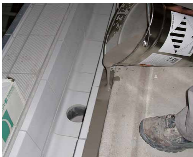
Zur Herstellung einer kapillarbrechenden Fuge im Schwimmbadbau wird Sopro Epoxi-Grundierung mit Sopro Quarzsand grob 0,4–0,8 mm und Sopro Kristallquarzsand in Raumteilen 1 : 1 : 1 abgemischt (in Gewichtsteilen 1 : 1,5 : 1,5).
